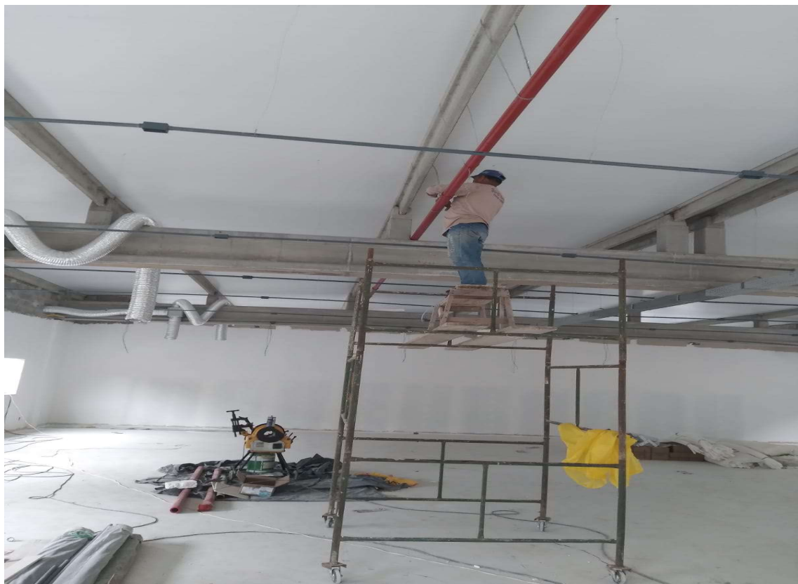
Foto 17: Item 19: Instalações de Combate a Incêndio;
