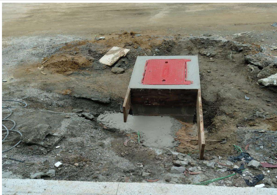
Foto 19: Item 19: Instalações de Combate a Incêndio;
