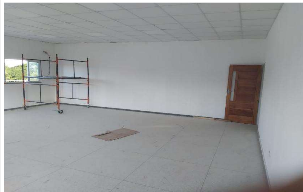
Foto 14: Forro e Luminárias LED;
