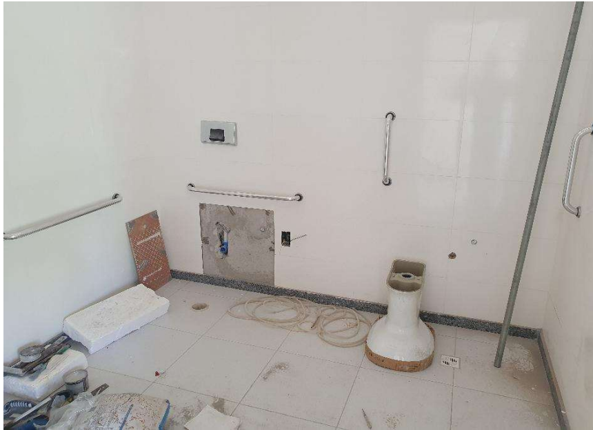
Foto 22: Item 25.26: Válvula descarga cromada;
