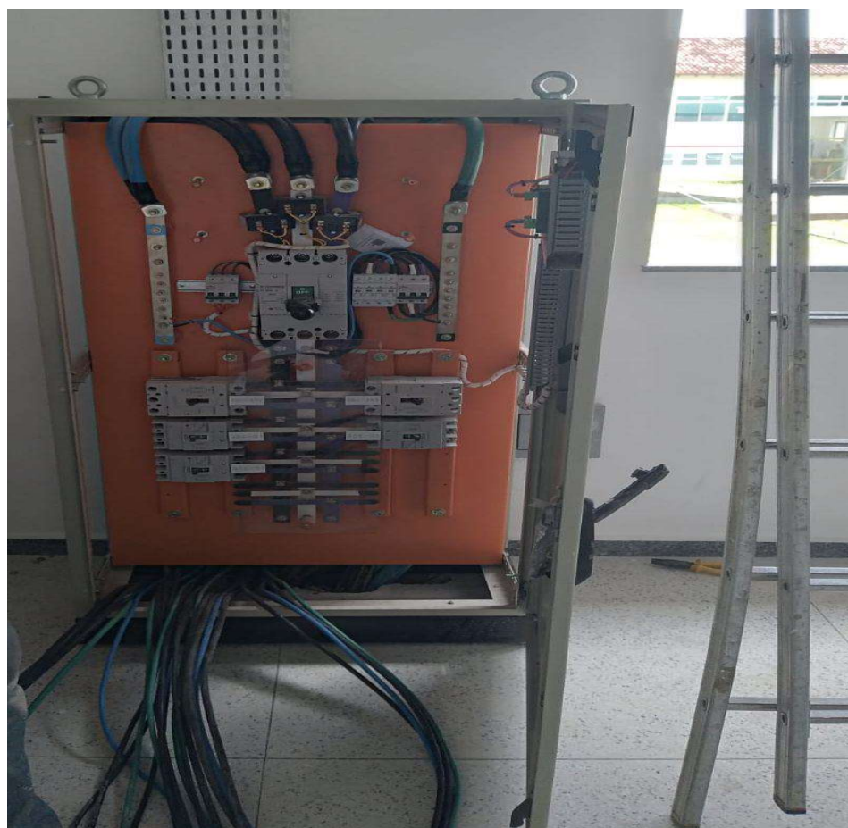
Foto 10: Item 15.1.4: Painel de Entrada de energia;
