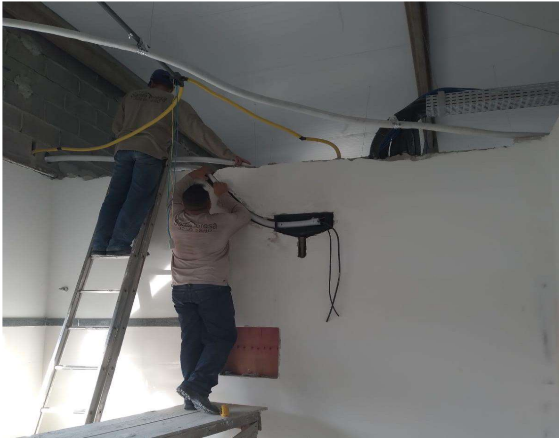
Foto 24: Itens 26.3, 26.4, 26.5 e 26.6: Tubulação em cobre para ar condicionado;
