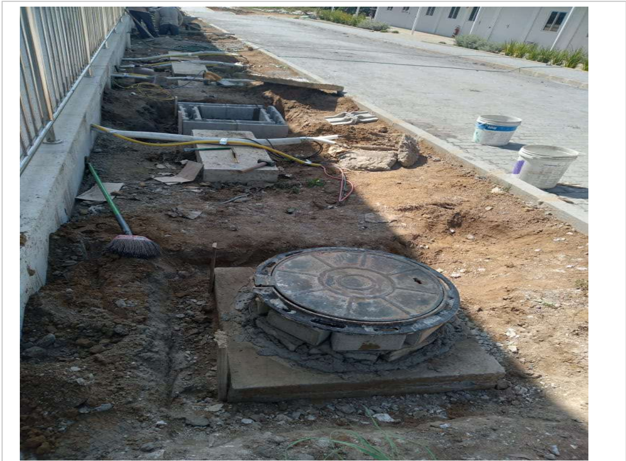
Foto 3: Levantamento das tampas das caixas;
