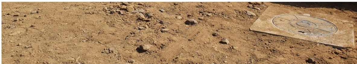
Foto 10: Item 14.5.11: Tampas FoFo PV's água pluvial;
