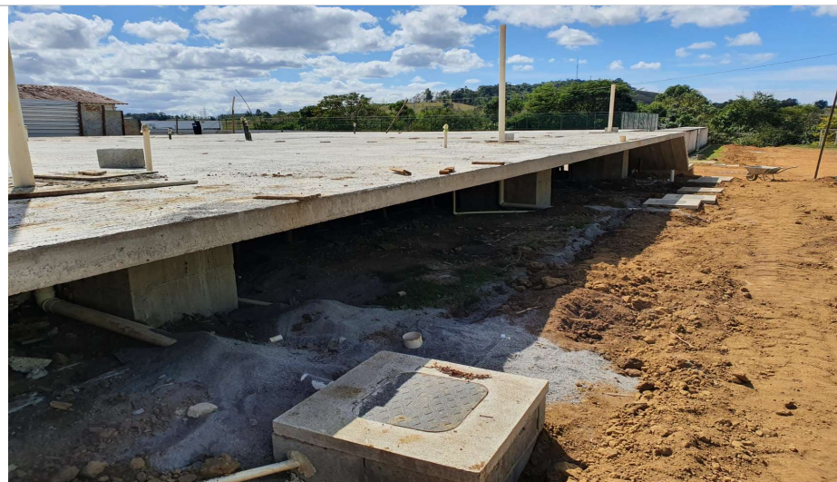
Foto 2: Itens 14.4.1 a 14.4.3: Tubos de 40mm, 50mm e 100mm;
