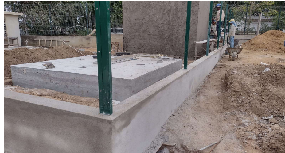
Foto 17: Mureta Gradil; Alvenaria, chapisco e emboço cisterna elevada;
