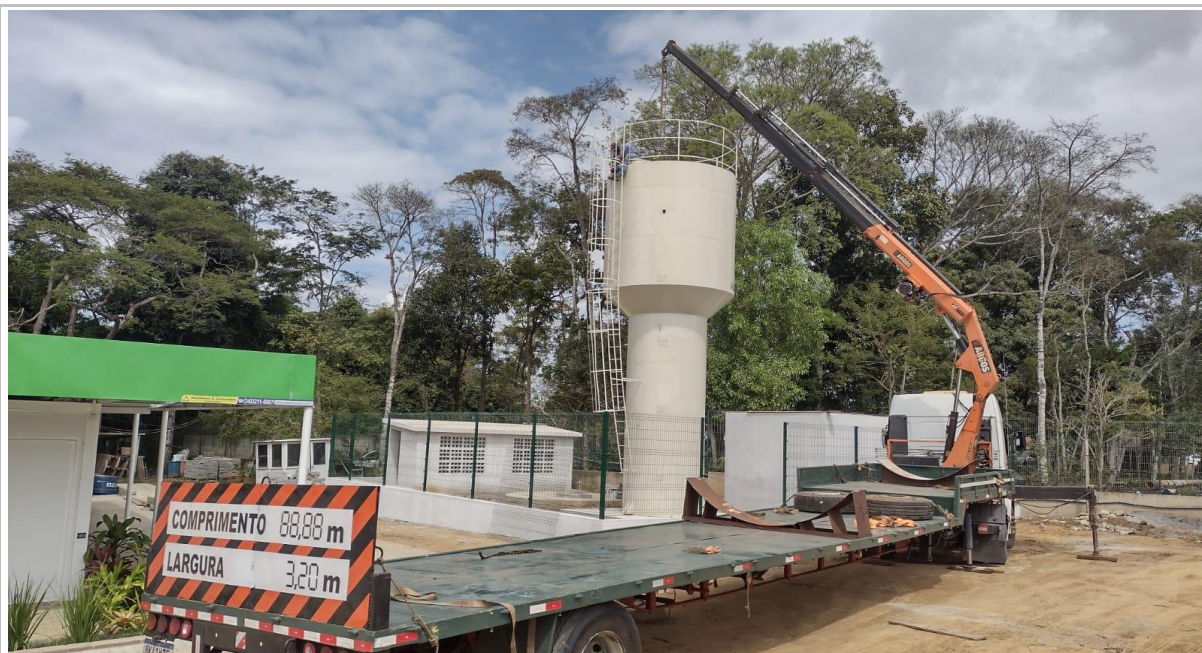
Foto 11: Item 14.13.1: Reservatório Metálico;
