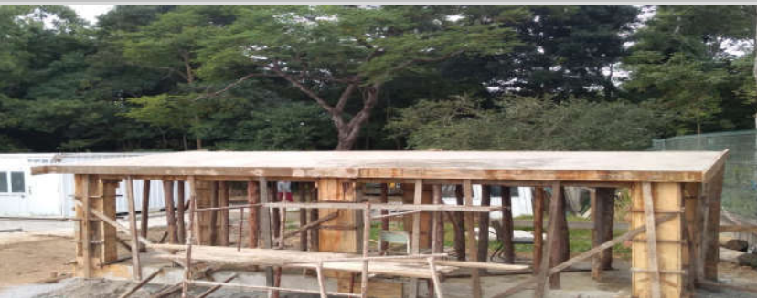
Foto 8: Itens 4.1.4 e 4.1.5: Concreto Reservatórios e Casa de Bombas, Item 4.1.6: fôrmas do reservatório e Itens 4.1.11 a 4.1.13 e 4.1.16 a 4.1.19; Armadura Reservatórios e Casa de Bombas ;
