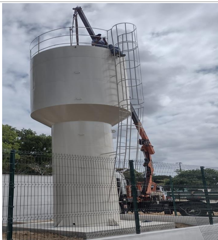
Foto 12: Item 14.13.1: Reservatório Metálico;
