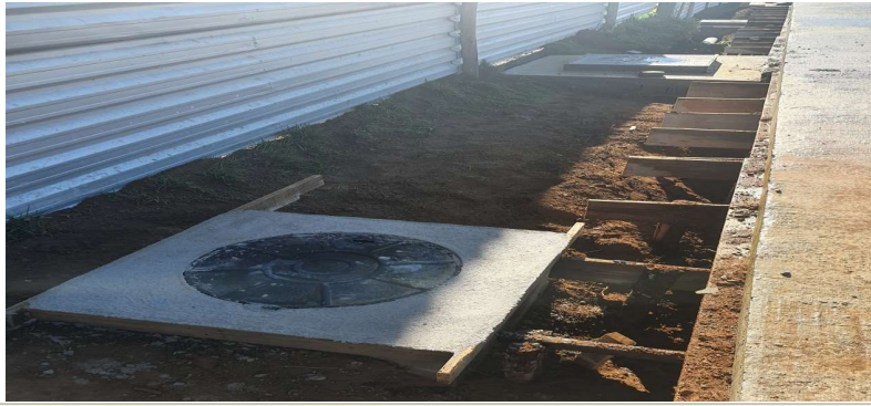
Foto 8: Itens 14.1.5 a 14.1.5: Caixas de Inspeção, Areia, Gordura, Sifonada;
