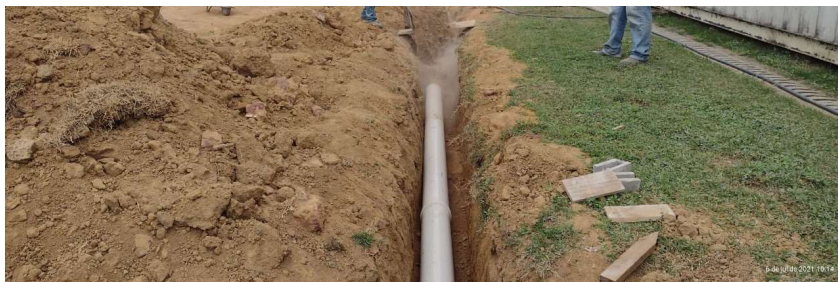
Foto 12: Itens 14.12.2: Tubo rígido 200mm - Rede de Drenagem Pluvial (escavação, tubo e reaterro com areia);
