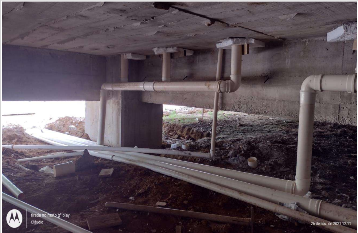
Foto 17:Instalações HS sobre a laje;
