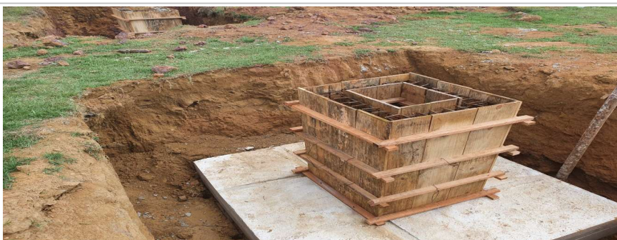
Foto 8: Item 4.1.6: Montagem de Fôrma; Item 4.1.9 a 4.1.15: Armadura de Bloco, Viga e Sapata
