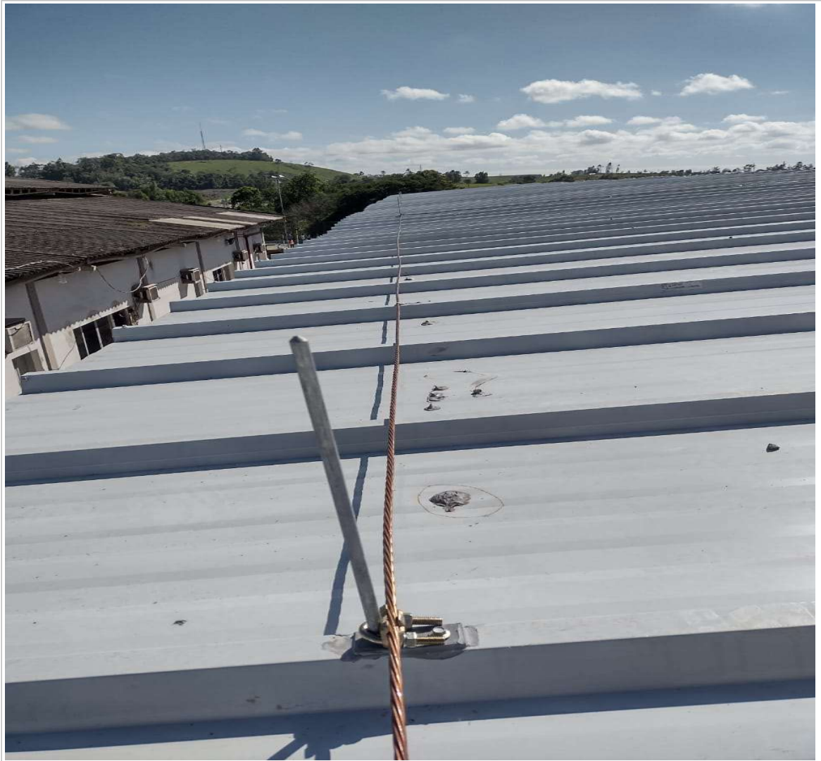
Foto 9: Item 18: Instalações SPDA;
