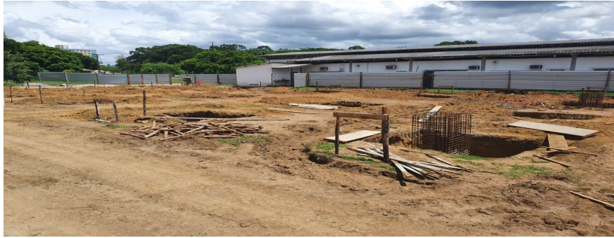
Foto 4: Item 3.2.1: Escavação Sapatas; Item 3.2.3: Carga de Material Escavado; Item 3.2.3: Retirada de Material Escavado
