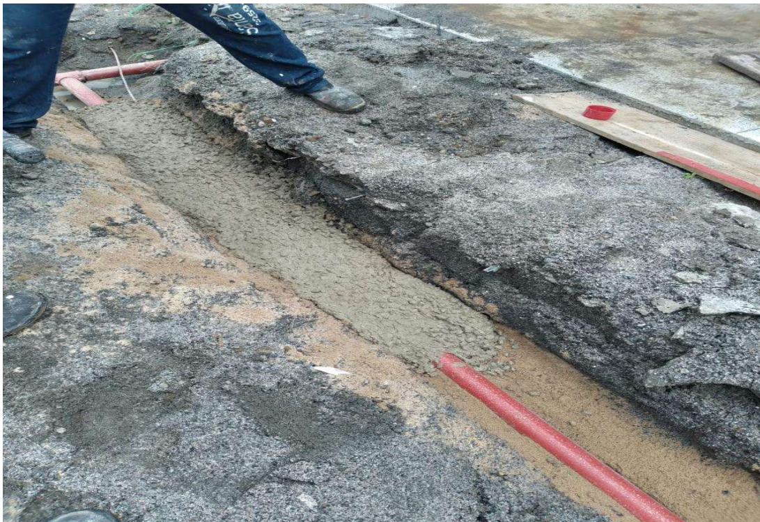
Foto 18: Item 19: Instalações de Combate a Incêndio;
