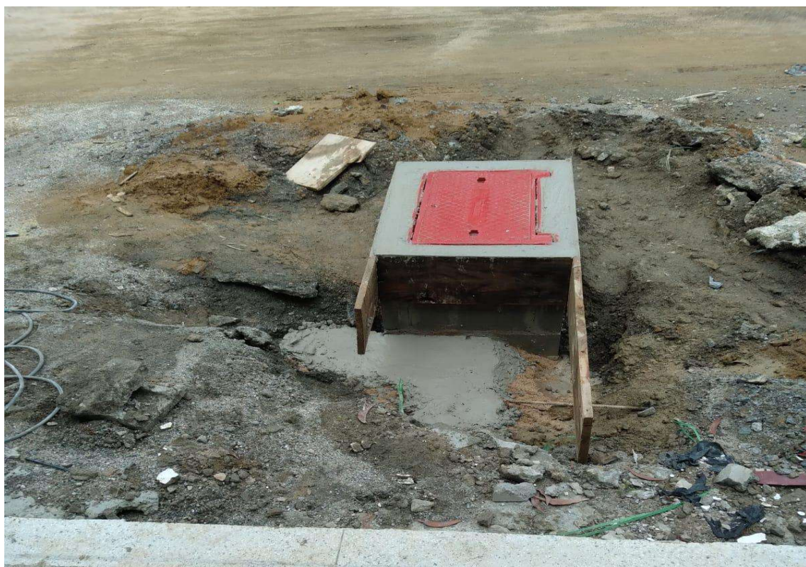
Foto 19: Item 19: Instalações de Combate a Incêndio;
