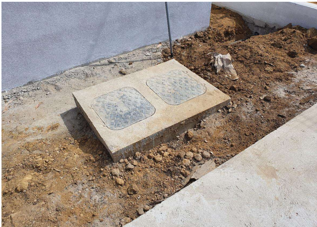
Foto 8: Item 14.5.7: Caixa de proteção dos filtros;
