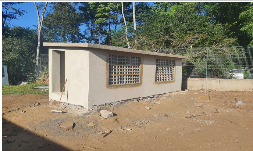
Foto 1: Item 5.1.1 : Alvenaria Casa de Bombas e Cisternas, Item 12.2.2: Chapisco e Item 12.2.3: Emboço;
