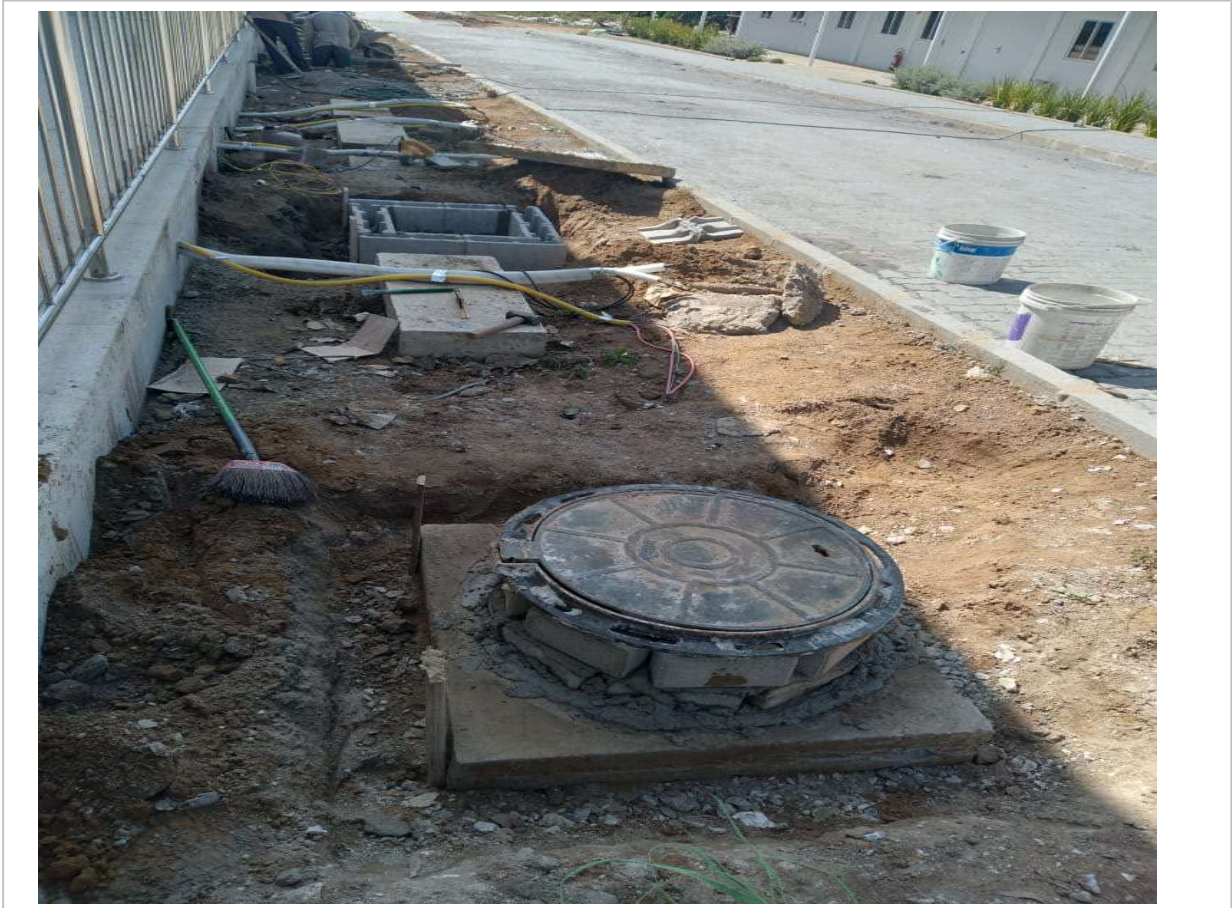
Foto 3: Levantamento das tampas das caixas;
