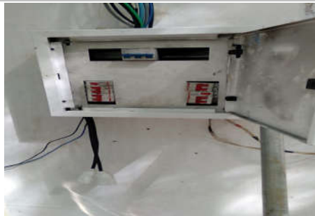
Foto 7: Item 2.2.7: Entrada provisória de energia elétrica
