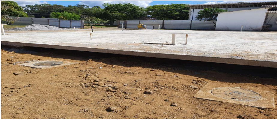
Foto 4: Item 14.5.11: Tampas FoFo PV's água pluvial;
