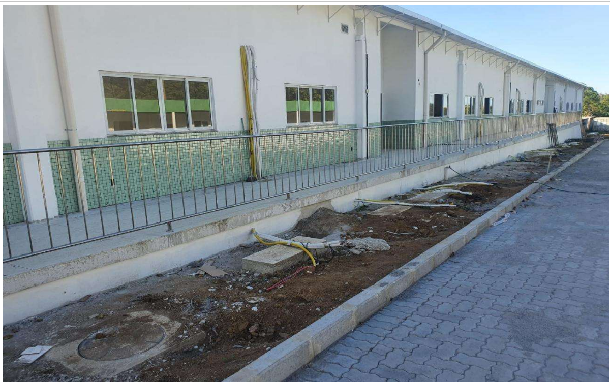
Foto 2: Instalação de Revestimento Externo, Parede sob a laje suspensa e Guarda Corpo;
