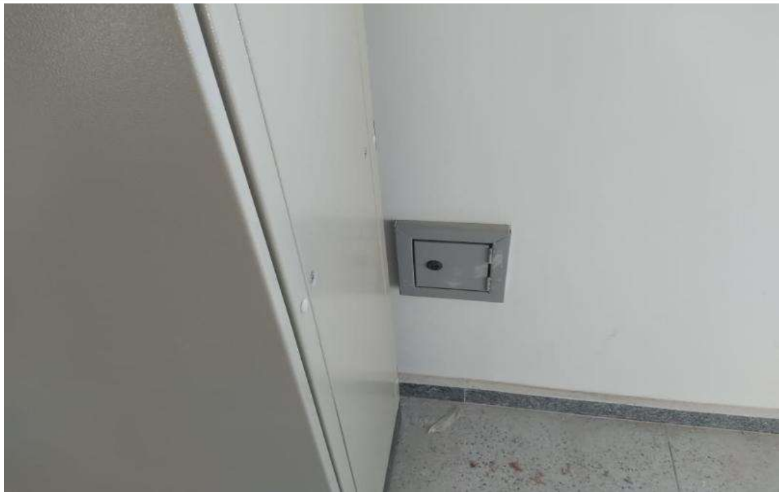
Foto 11: Caixa Equalização de potenciais;
