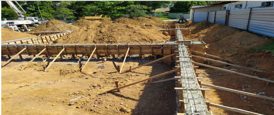
Foto 3: Item 4.1.1: Concretagem de vigas; Item 4.1.6: Fôrmas de Vigas; Item 4.1.9 a 4.1.15: Armadura de Vigas;
