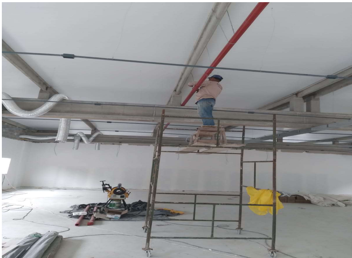
Foto 17: Item 19: Instalações de Combate a Incêndio;
