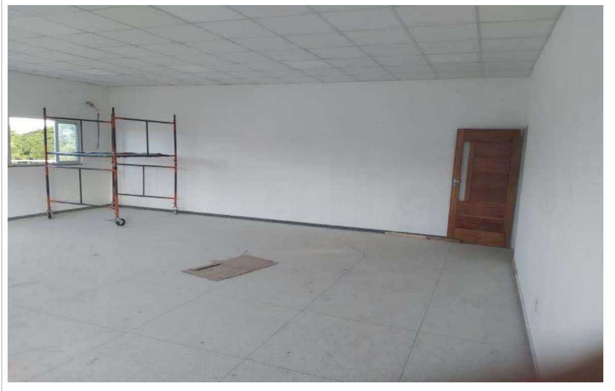
Foto 14: Forro e Luminárias LED;
