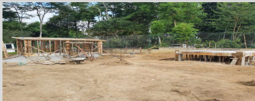
Foto 7: Itens 4.1.4 e 4.1.5: Concreto Reservatórios e Casa de Bombas, Item 4.1.6: fôrmas do reservatório e Itens 4.1.11 a 4.1.13 e 4.1.16 a 4.1.19; Armadura Reservatórios e Casa de Bombas ;
