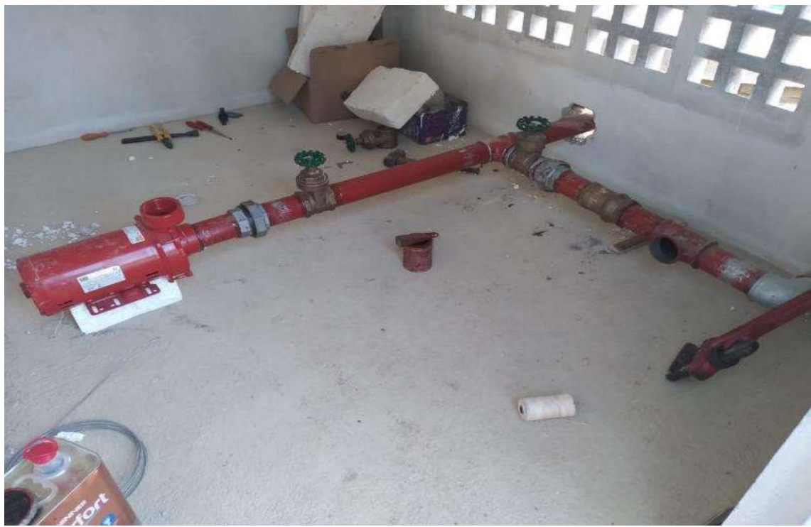
Foto 11: Bomba combate Incêndio;
