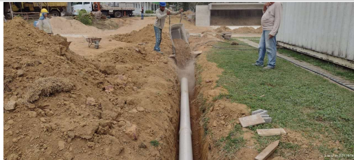
Foto 9: Itens 14.12.2: Tubo rígido 200mm - Rede de Drenagem Pluvial (escavação, tubo e reaterro com areia);
