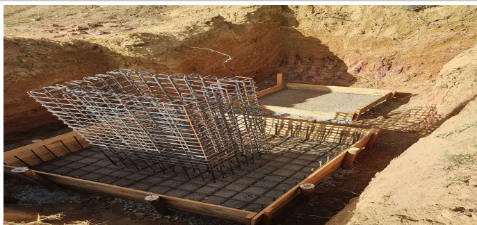
Foto 3: Item 4.1.2: Concreto Magro; Item 4.1.6: Montagem de Fôrma; Item 4.1.9 a 4.1.15: Armadura de Bloco, Viga e Sapata
