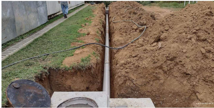
Foto 8: Item 14.12.2: Tubo rígido 200mm - Rede de Drenagem Pluvial (escavação, tubo e poço de visita);
