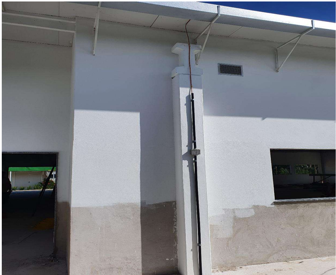
Foto 16: Item 18: Instalações de SPDA;
