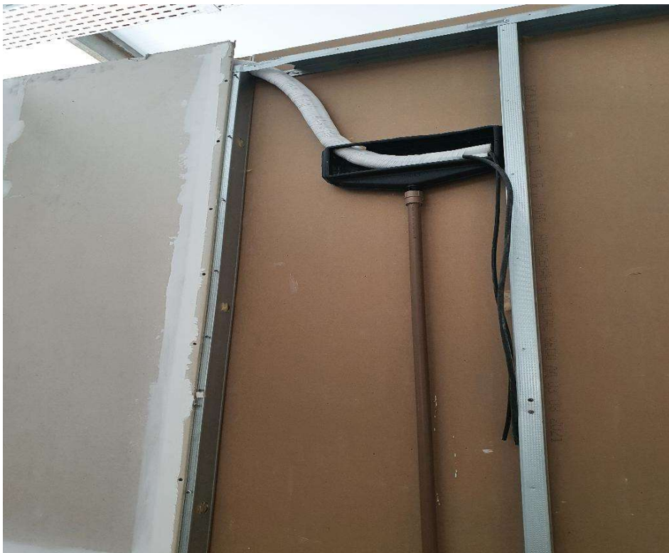
Foto 23: Itens 26.3, 26.4, 26.5 e 26.6: Tubulação em cobre para ar condicionado;
