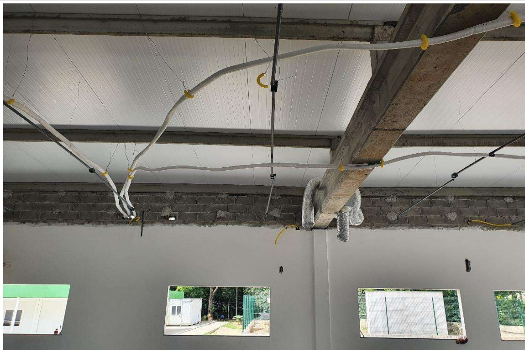
Foto 25: Itens 26.3, 26.4, 26.5 e 26.6: Tubulação em cobre para ar condicionado;
