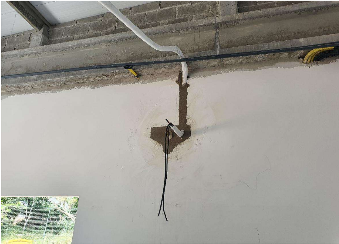
Foto 26: Itens 26.3, 26.4, 26.5 e 26.6: Tubulação em cobre para ar condicionado;
